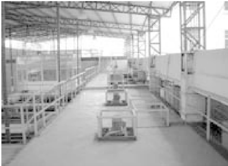
电镀工业园废水处理厂
