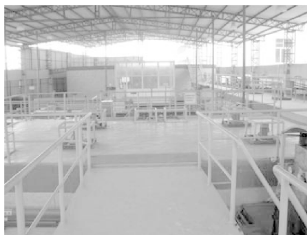
电镀工业园废水处理厂
